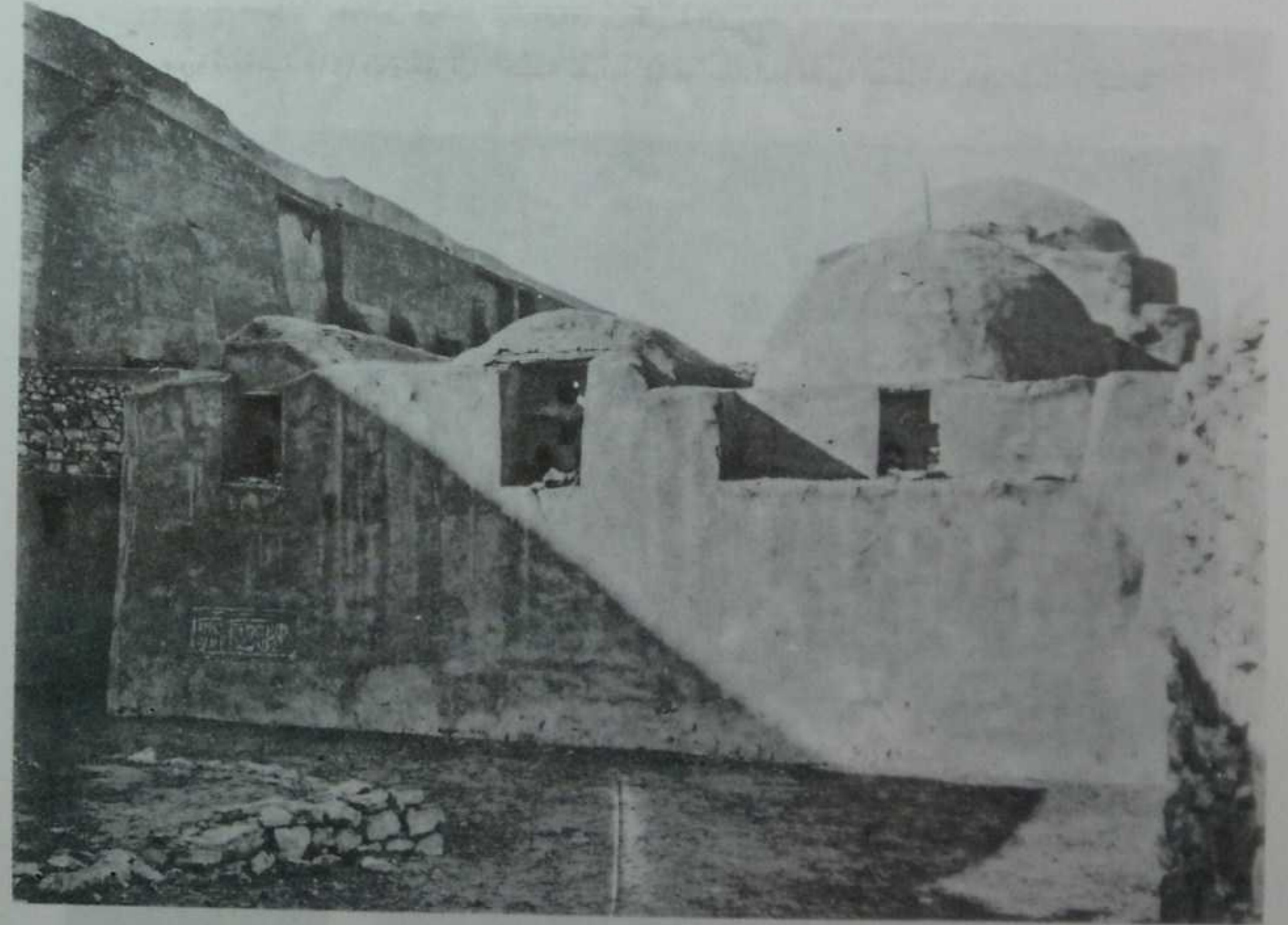
٩٥ - كنيسة أبا سخيريون من الخارج من الجهة القبليّة (قبل الترميم الأخير عام ١٩٧٤). ويظهر فيها كيف ارتفعت الأرضية خارجها (مقدار ٢ متر).
